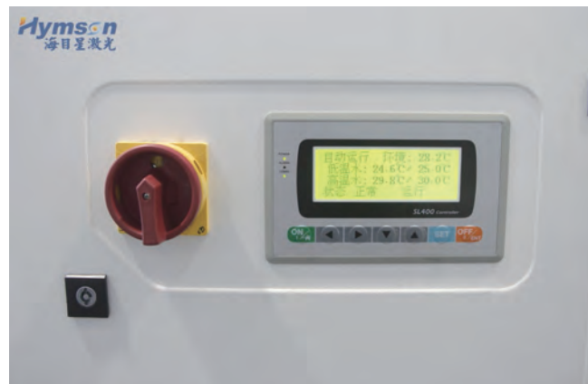
图 4 检查冷水机温度是否正常
